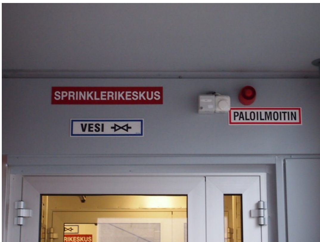
Paloilmoitinkeskus ja muut keskukset ja sulut on opastettu hyvin
